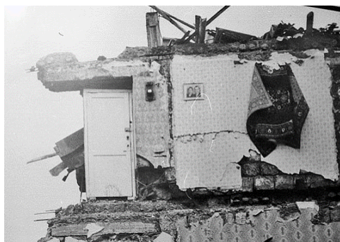
Рис. 2.8. Последствия Спитакского землетрясения
